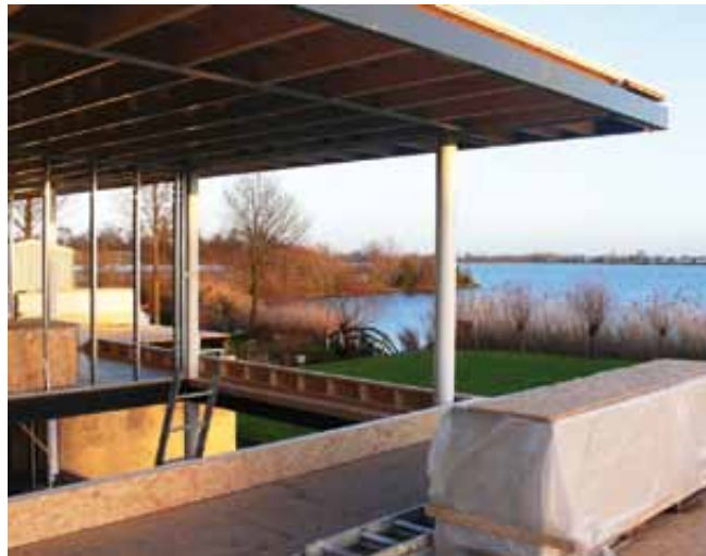
Woonhuis zicht op het water vanaf de woning in aanbouw - Ter Aar
